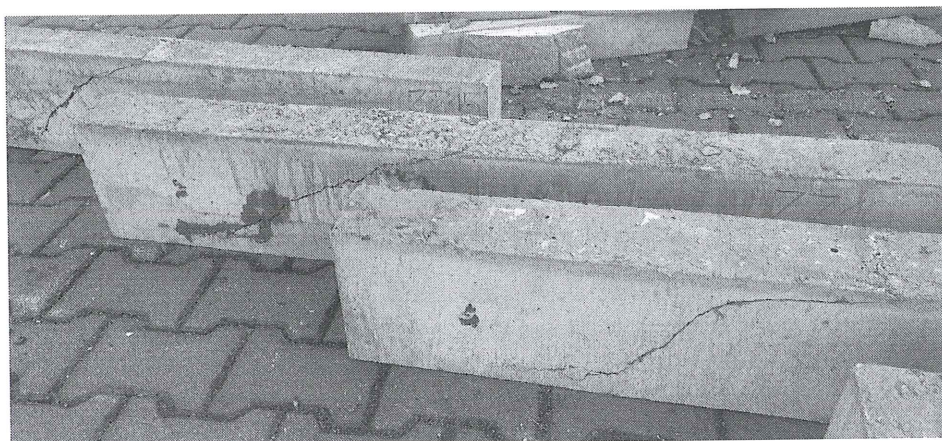
Obr. 5 Malé konstrukční prvky – nosníky bez smykové výztuže
